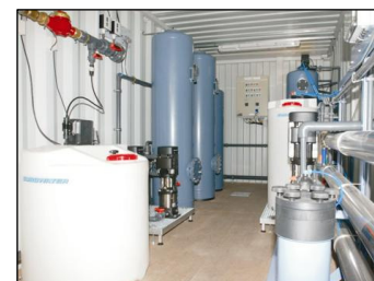
Eksempel på specialdesignet permanent løsning med dosering, kulfiltrering, blødgøring og omvendt osmose
