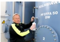
Billede 1 – ”Måling” | Jan Pedersen, driftsleder på Fanø Vandværk, tager her en vandprøve fra det nye ionbytteranlæg.
