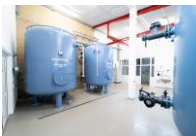
Billede 2 – ”Anlæg” | Ionbytteranlægget består af to specialbyggede beholdere, der kan rense hele 150 m3 (150.000 liter) drikkevand i timen.
